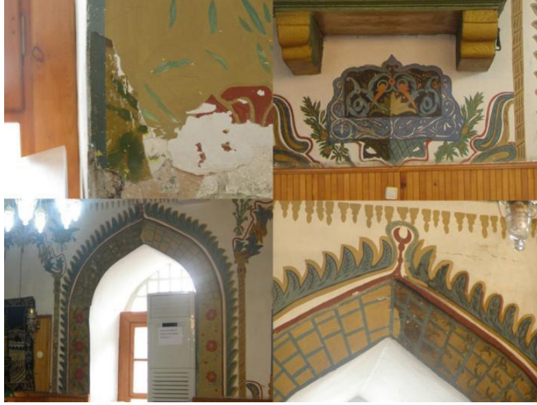
Resim 16. Duvar Resimlerinin Eski Onarımlarında Yapılmış Olan Yenilemeler (E Yetiş- 2015).
