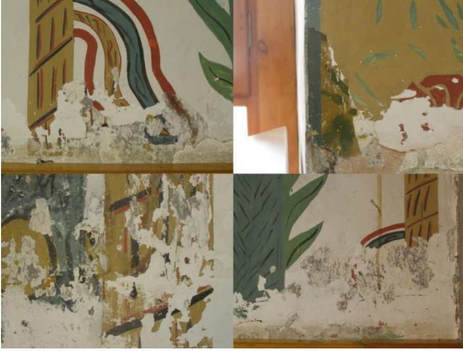
Resim 15. Resim Yüzeylerindeki Boya Dökülmesi Örnekleri (E. Yetiş, 2015).
