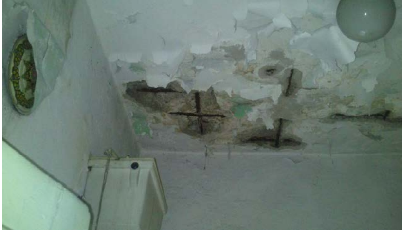
Şekil 2. Binanın tavan döşeme durumu.
