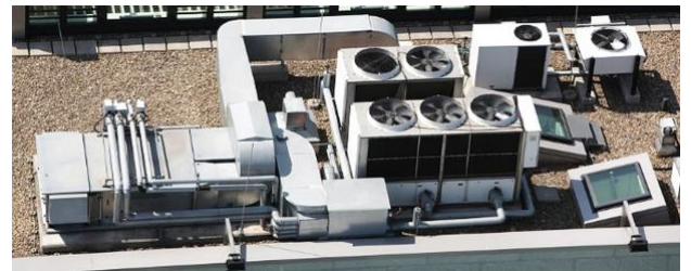
Şekil 5. Bir HVAC Sistemi Dış Ünitesi ve Çatıda Bulunma Durumu.
