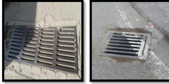
Şekil 21. Necip Fazıl Kısakürek Sokağı üzerinde yer alan yol ızgaraları
