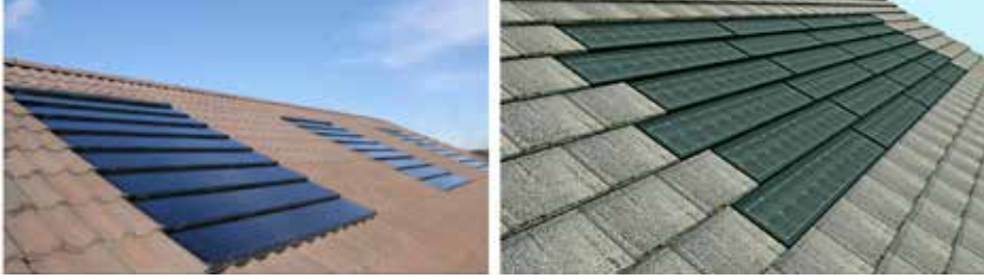
Şekil 4.2: Çatıya entegre PV panel uygulamaları [21, 21].
