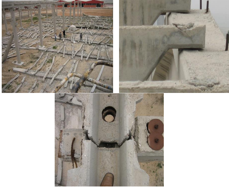
Şekil 12. Kirişlerde oluşan kesme hasarları
