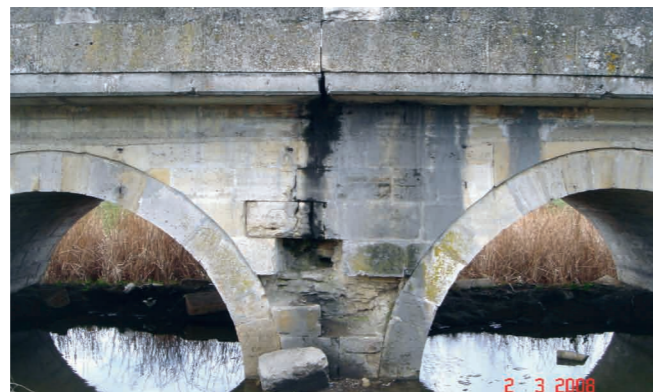
Resim 2: Edirne Uzunköprü ilçesi Uzunköprü Kemer ayağındaki deformasyon.
