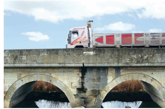
Resim 9: Edirne Uzunköprü ilçesi Uzunköprü Ağır tonajlı araçlardan oluşan deformasyonlar.
