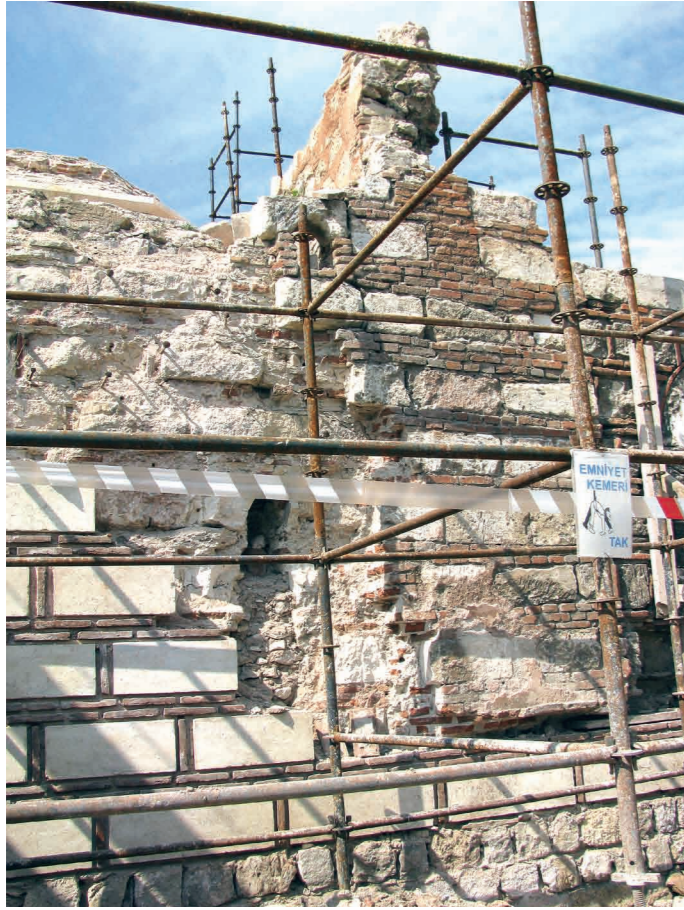
Şekil 3: Özgün duvar dokusunun ve malzemelerinin ortadan kaldırıldığı bir uygulama
