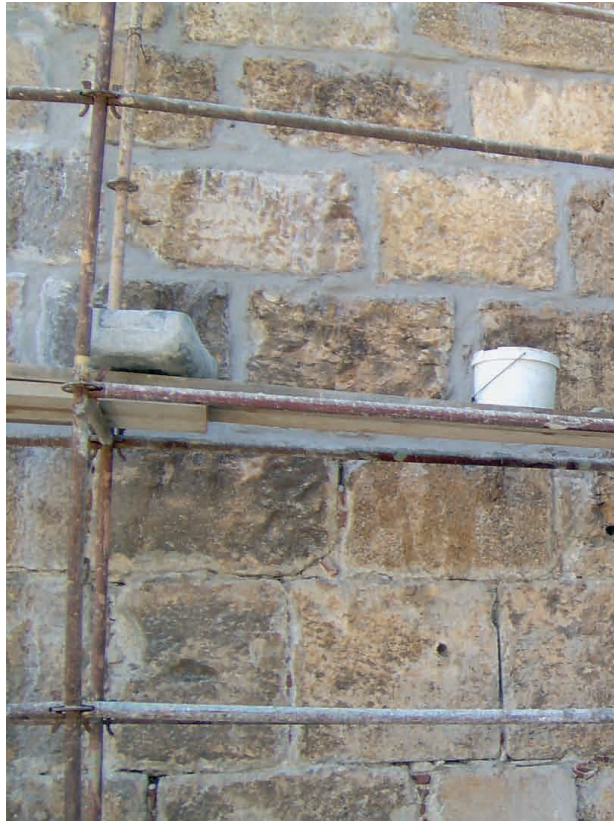
Şekil 5: Çimento, kireç, kum ve tuğla tozu ile hazırlanan sözde horasan harcı kullanılarak yapılan onarımlara bir örnek
