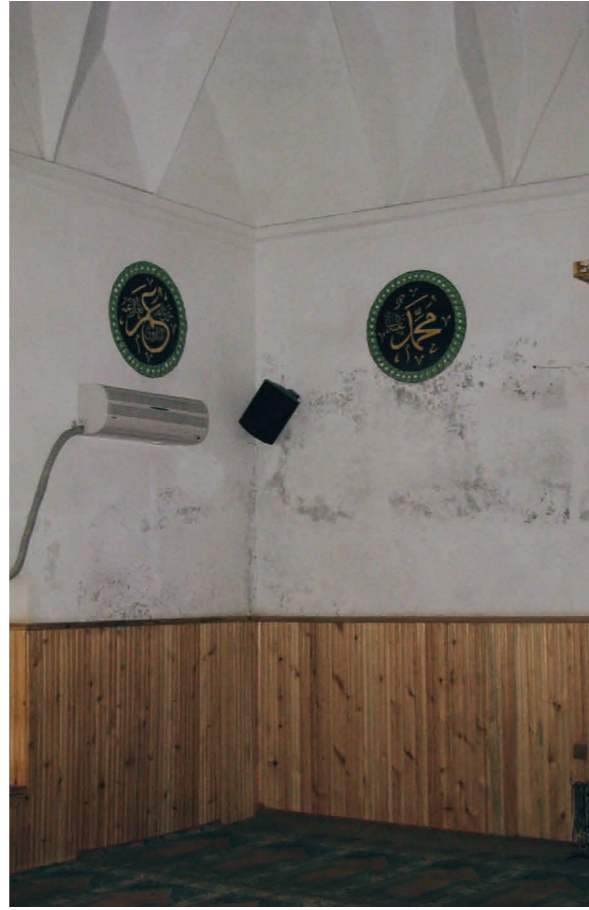
Şekil 4: Tarihi bir yapıda çimento sıvanın kullanılması sonucu ortaya çıkan tuzlanma ve sorunları
