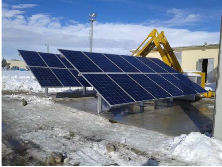
Şekil 5. Güneş enerji panelleri.
