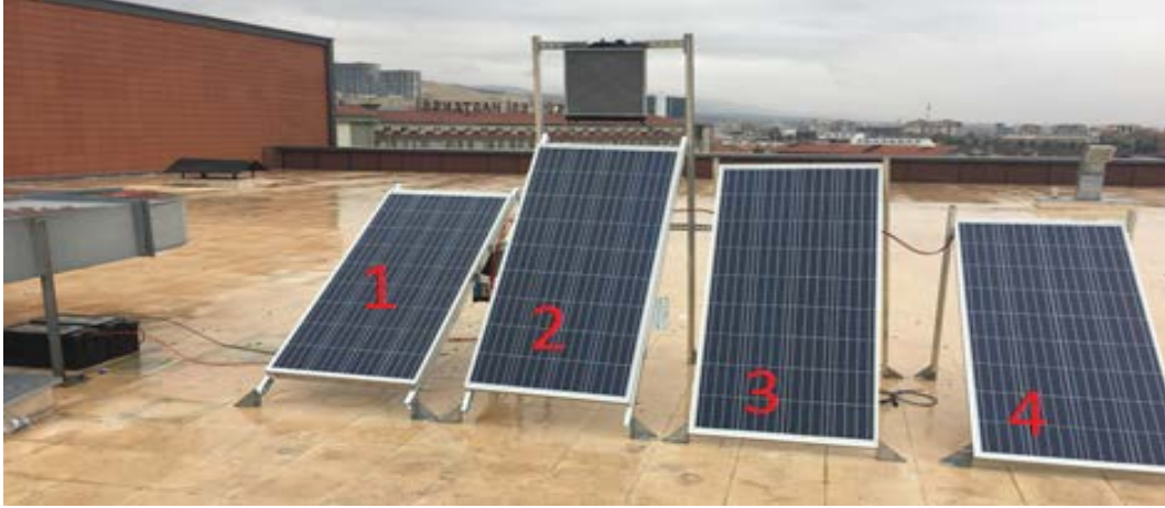
Şekil 1. Kurulan sistemin önden görünüşü (Figure 1. Front view of the installed system)
