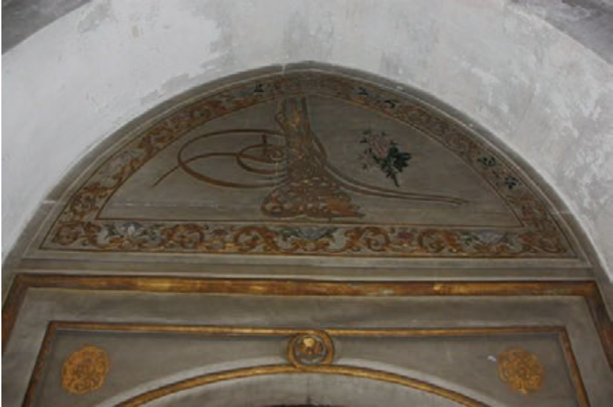
Foto. 24: Restorasyon Öncesi Hazine-İ Kütüb Bölümünün Mermer Tuğra Ve Bezemelerin Durumu.
