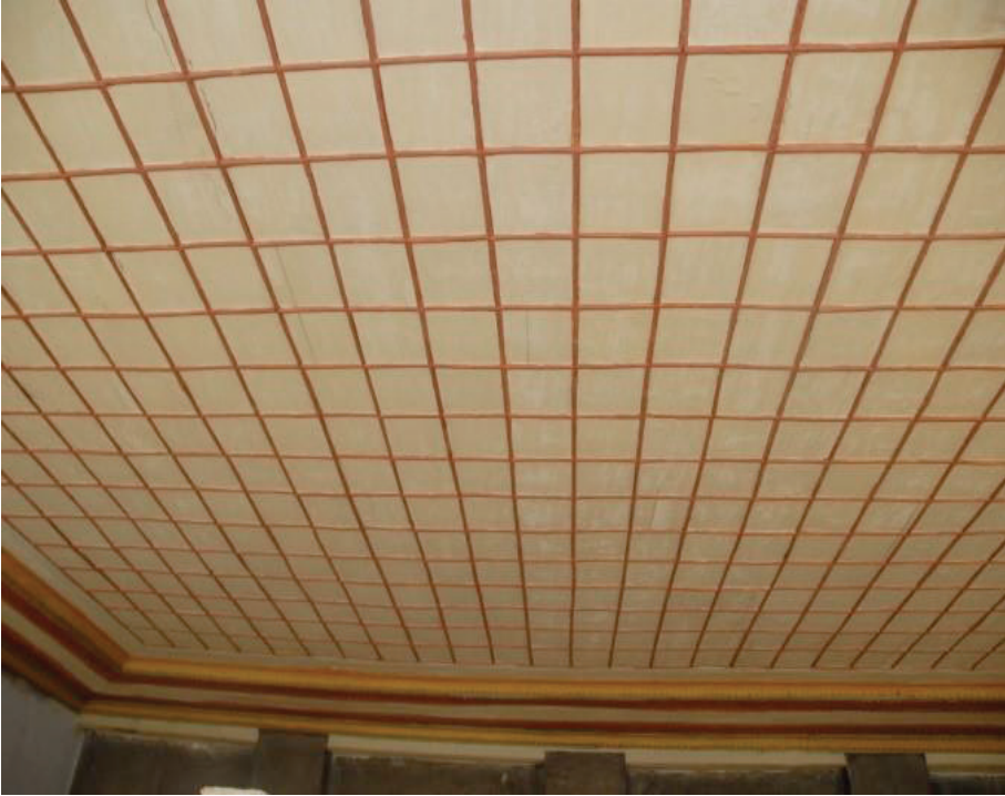
Foto. 10: Restorasyon Öncesi Okuma Odası Tavanın Durumu
