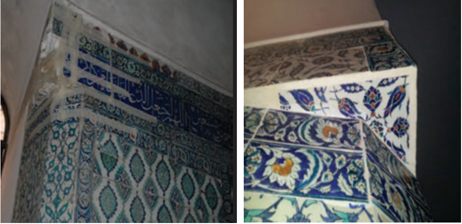
Foto. 32-33: Restorasyon Öncesi Ve Sonrası Yapı İçinde Bulunan Çinilerin Durumu.
