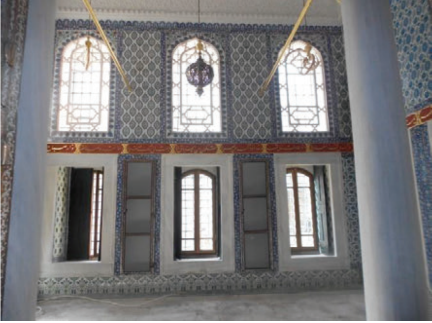
Foto. 37: Restorasyon Öncesi Ve Sonrası Yapı İçinde Bulunan Çinilerin Durumu.
