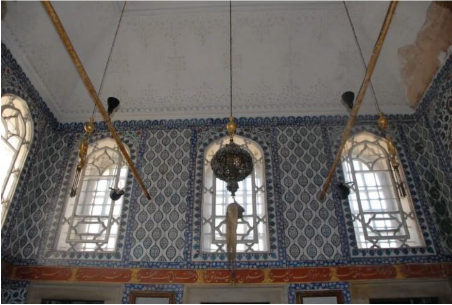
Foto. 36: Restorasyon Öncesi Ve Sonrası Yapı İçinde Bulunan Çinilerin Durumu.
