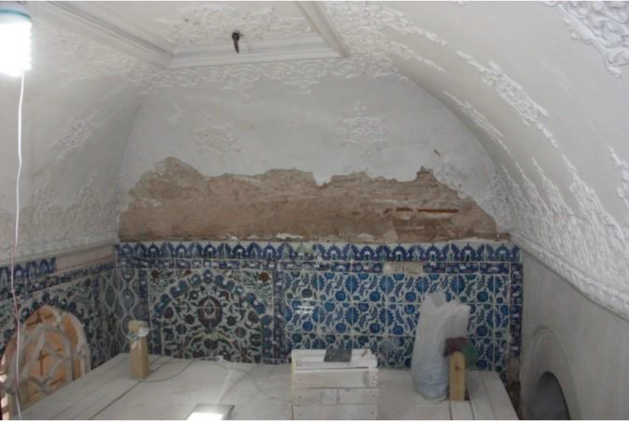
Foto 22: Restorasyon Öncesi Hazine-İ Kütüb Bölümünü Tonozunun Durumu.
