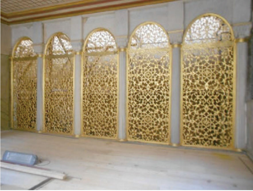
Foto. 13: Restorasyon Öncesi Sonrası Pirinç Şebekenin Durumu
