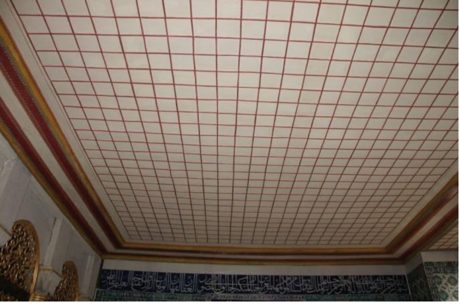
Foto. 11: Restorasyon Sonrası Okuma Odası Tavanının Durumu.
