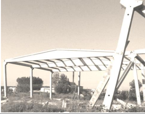
a) Taşıyıcı sistemin genel hasarı
