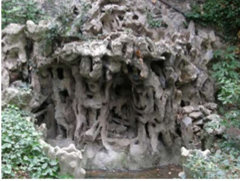
Figür 21. Dört numaralı köşkün bahçesinde bulunan kaskadlı grottonun 2015 yılındaki durumu. Yapıda kısmi çökmeler meydana gelmiştir.
