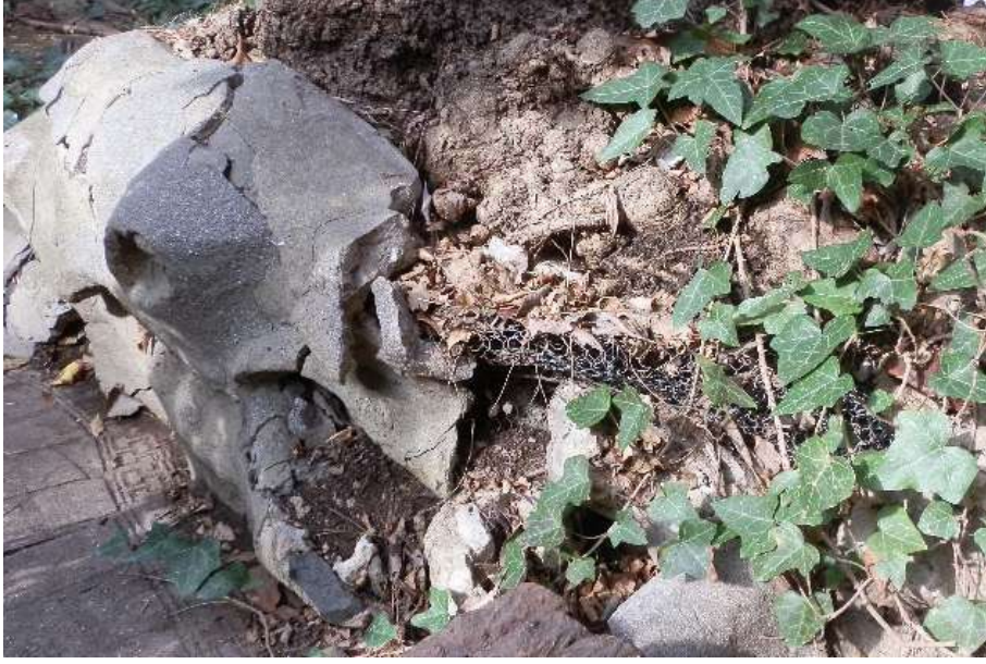
Figür 9. Küçük havuzun yıpranan sıvalarının dökülen kısımlarında görülen galvanizli sıva teli.
