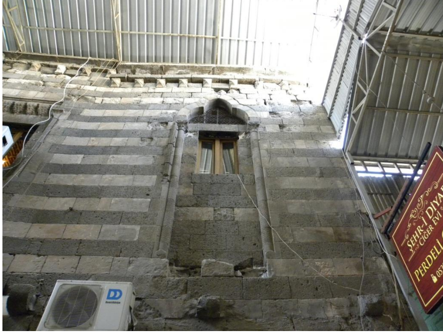
Şekil 11: Özgün Dokuyu Bozan Eklentiler: Tesisat Elmanları, Metal Taşıyıcılar, Sac üst örtü, Klima Dış Ünitesi.
