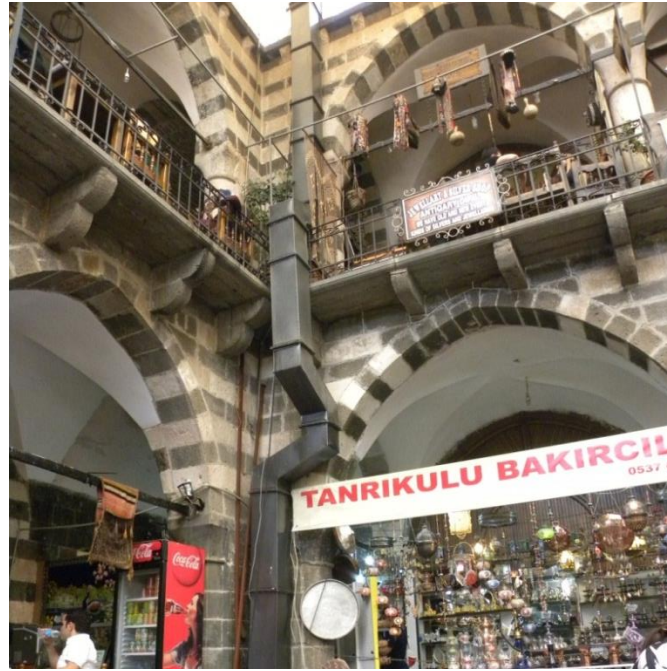
Şekil 8: Özgün Dokuyu Bozan Eklentiler: Duman Bacası, Soğutucular, Tabelalar, Elektrik ve Sıhhi Tesisat Elmanları, Satış Eşyaları.
