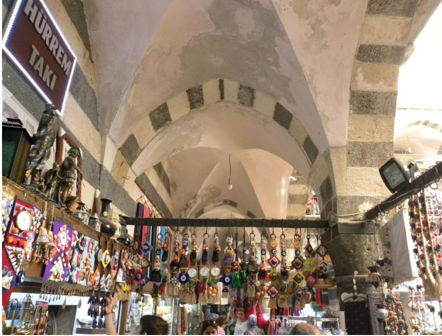
Şekil 10: Özgün Dokuyu Bozan Eklentiler: Elektrik Tesisatı, Gölgelekler, Tabelalar, Satış Eşyaları
