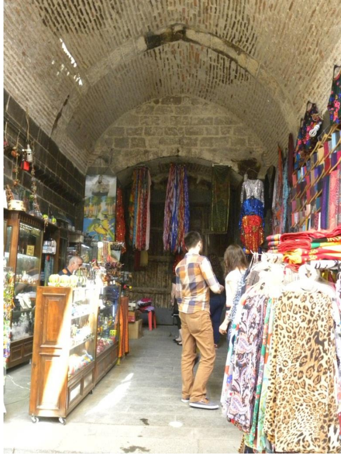
Şekil 16: Özgün Dokuyu Bozan Eklentiler: Elektrik Tesisatı, Gölgelekler, Tabelalar, Satış Eşyaları
