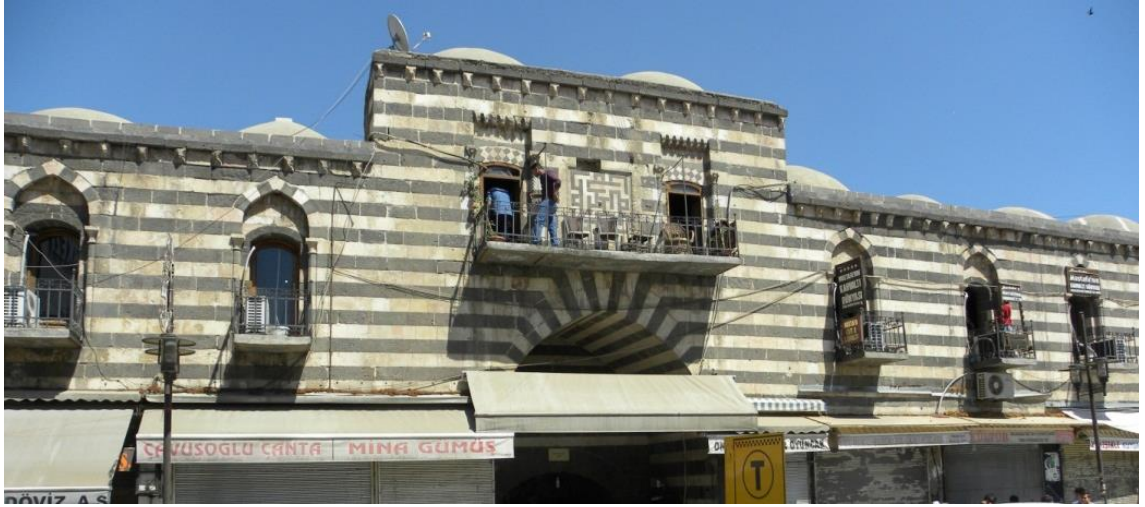
Şekil 4: Özgün Dokuyu Bozan Eklentiler: Çanak Anten, Klima Boruları, Kablolar, Gölgelikler, Tabelalar
