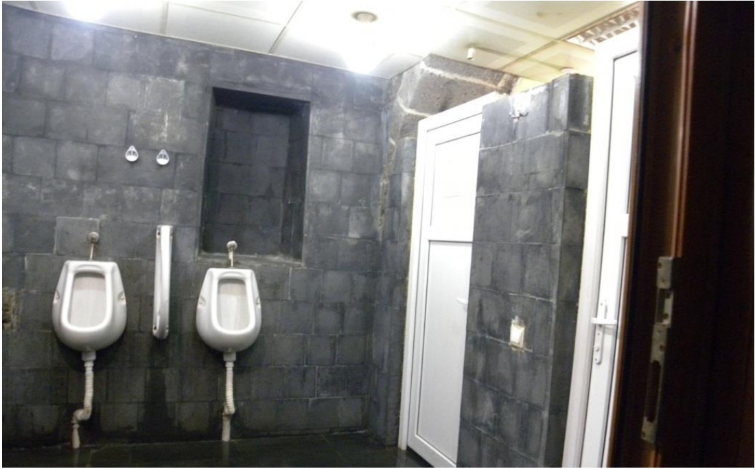
Şekil 14: Özgün Dokuyu Bozan Eklentiler: Elektrik ve Sıhhi Tesisat Elmanları, Pvc Doğramalar, Zemin ve Duvar Kaplaması.
