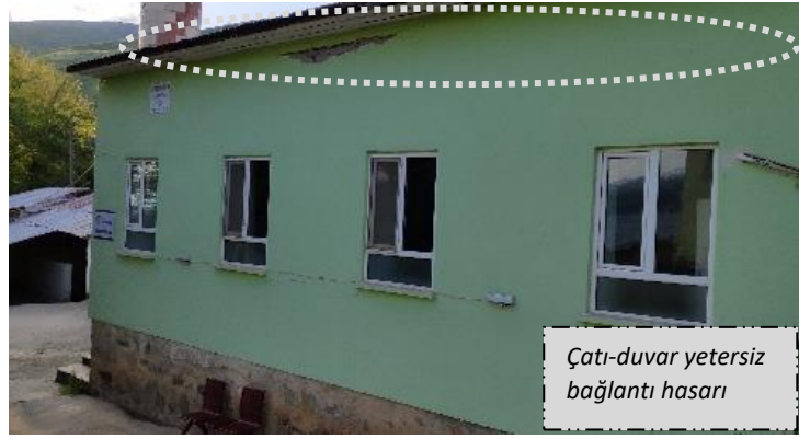
Şekil 16. Çatı ve Duvarlar Arasında Yetersiz Bağlantıya Bağlı Hasarlar
