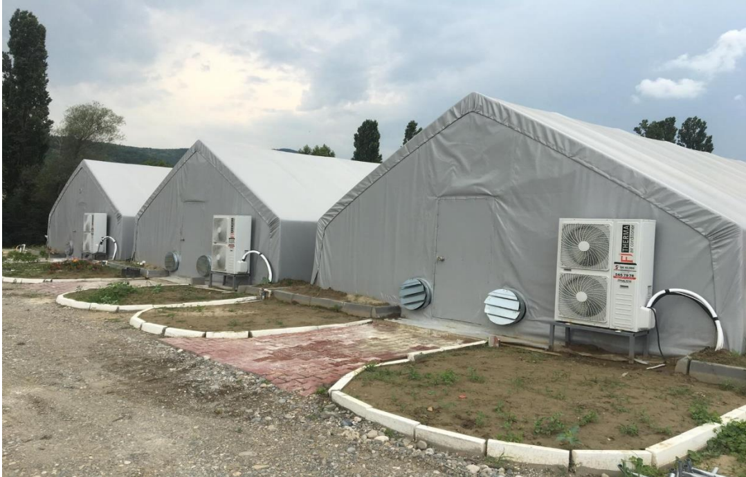
Şekil 2. Çatalca'da Faaliyet Gösteren İşletmenin Üretim Tesisinden Bir Bölüm
