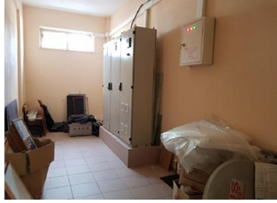
Şekil 14. Okulun elektrik dağıtımını sağlayan elektrik odası
