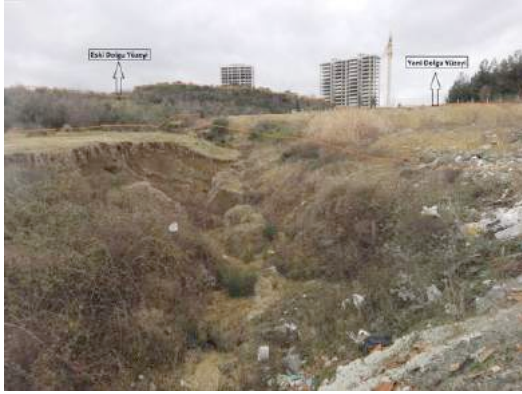
Fotoğraf 1. Çobanlı Mahalle Mezarlığı Yanındaki Eski Ve Yeni Dolgu Alanları. İnsan Etkisiyle Arazi Gençleşmiş, Erozyon Başlamıştır.
