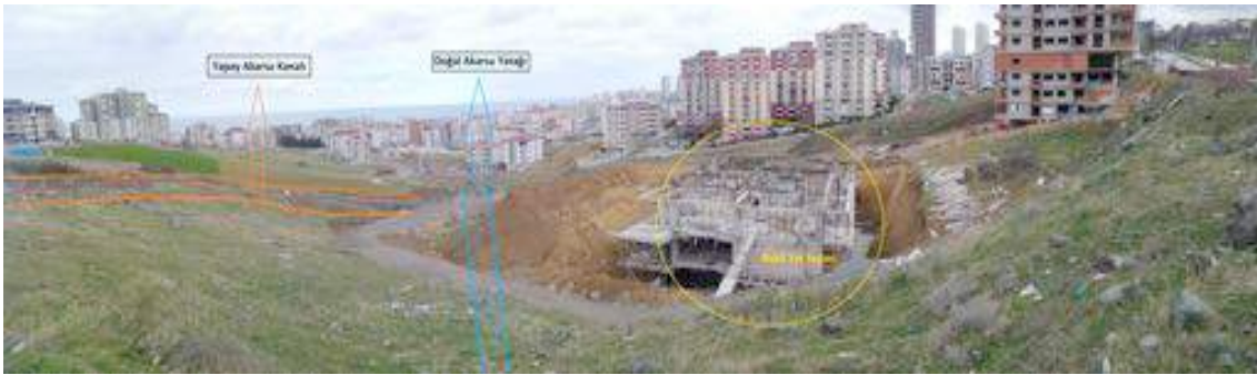
Fotoğraf 4. Doğal Akarsu Yatağının Yapay Kanala Alınması. Doğal Yatak İçinde Başlayan Konut İnşası, İlçede Olası Kuvvetli Oran Hava Durumunda Yapay Kanalin Patlayıp Yerleşmelerin Taşkına Uğramasına Sebep Olabilir.
