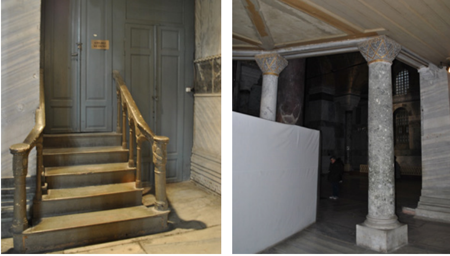
Resim 13. Hünkar Mahfili Merdiven. (Solda) Resim 14. Hünkar Mahfili Döşeme Altı, Taşıyıcı. (Sağda)
