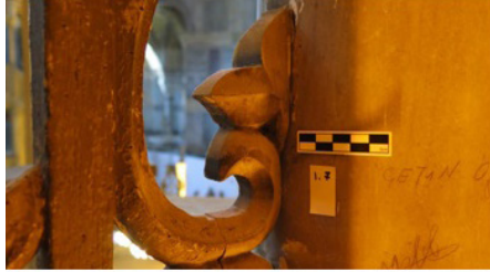
Resim 34, 1 Nolu Şebeke (1.7), Onarım/Yeni Malz. Kull.
