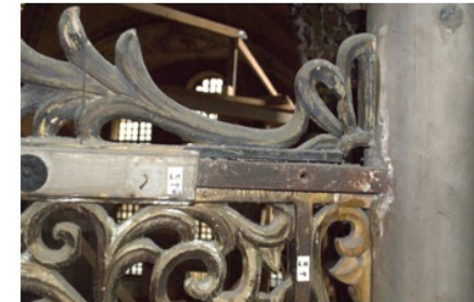
Resim 46, 6 Nolu Şebeke (6.15), demir gergi, korozyon.
