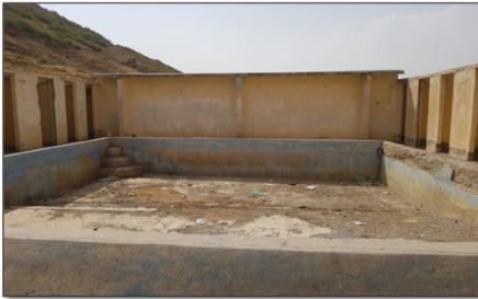
Şekil 6: Kullanım dışı bırakılan kaplıca binası
