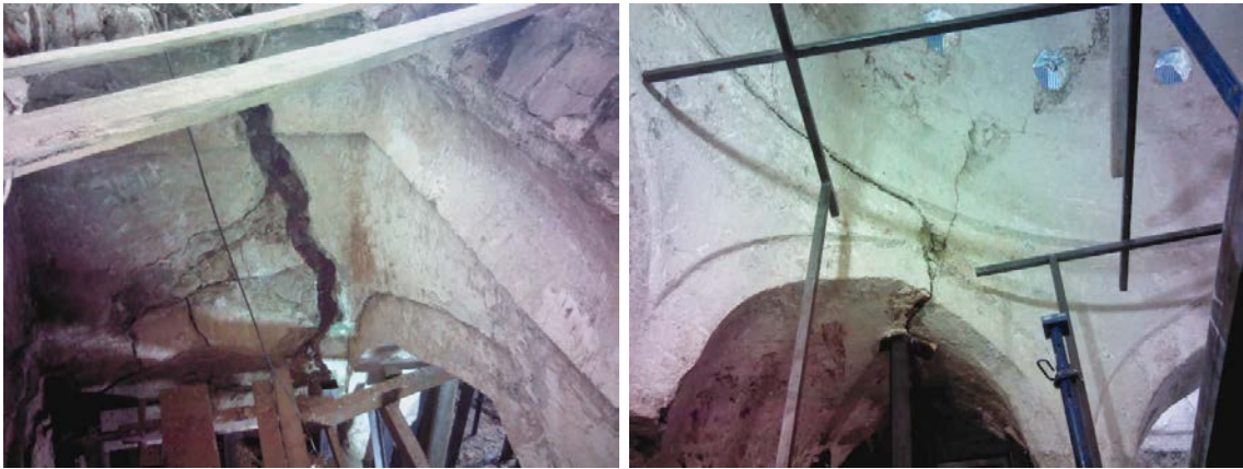
Şekil 16: Hamam bitkilenme mekanik ve kimyasal müdahalelerden sonra çatlak görünümü (sol), sıcaklık ana kubbeyi taşıyan kemerlerde görülen çatlakların yapının askıya alınması (sağ). (Kaynak: Emre Kishalı arşivi, 2016).
