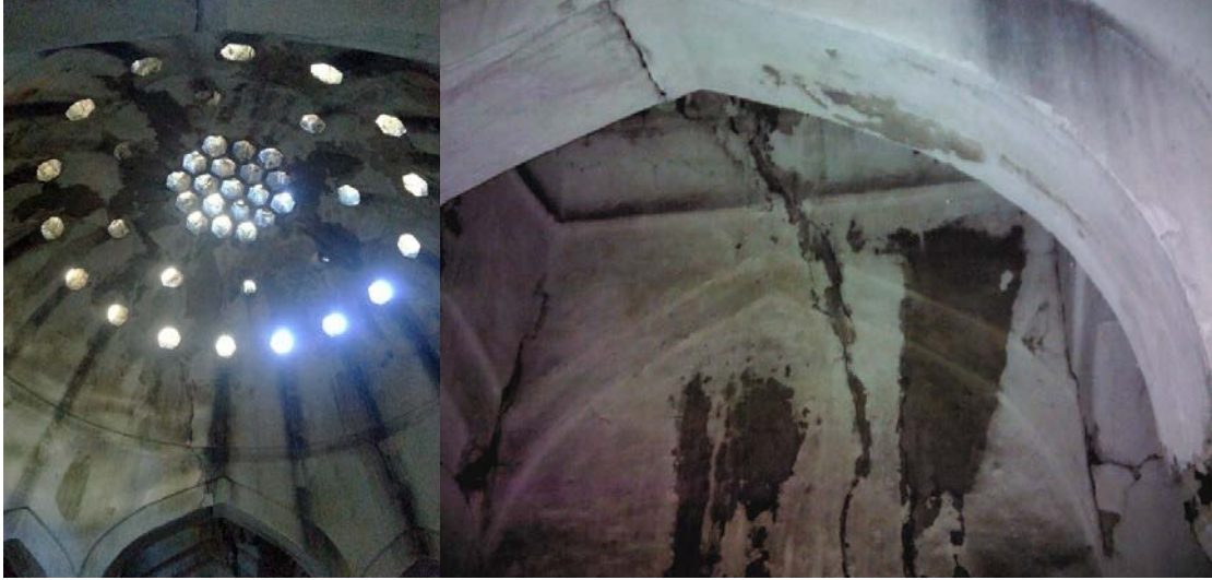
Şekil 4: Sıcaklık mekânı kubbe, kemer ve tonoz yapı elemanlarında gözlemlenen yapısal çatlaklar (Emre Kishalı arşivi, 2015)
