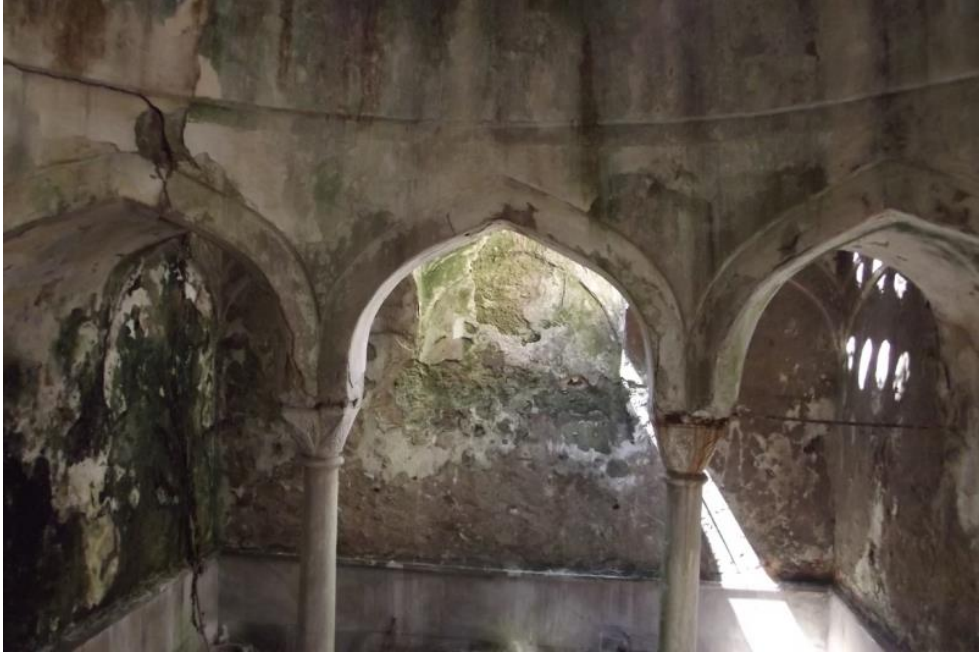
Şekil 5: Ilıklık mekânı kuzeybatı duvarı ve yapısal çatlaklar (Bahadır Bozdağ arşivi, 2015).
