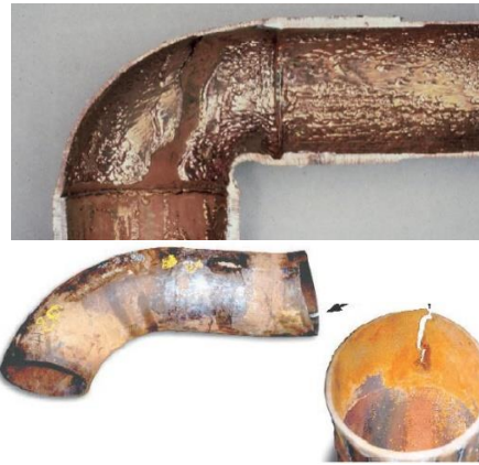
Şekil 1. Erozyon korozyonunun boru iç yüzeyinde görünümü (MEGEP 2012)
