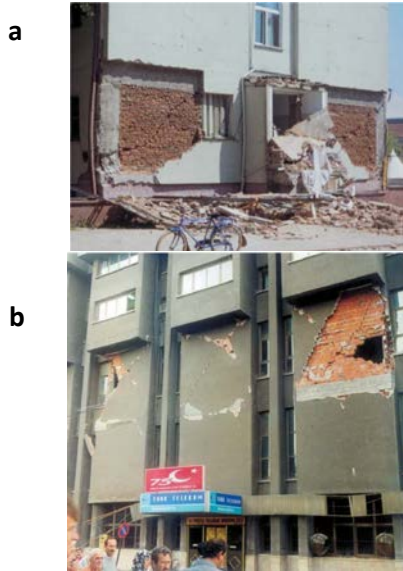
Şekil 1. Dolgu duvarların hasarı (a) düzlem içi, (b) düzlem dışı [9].
