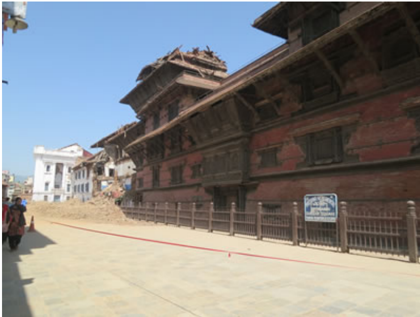
Şekil 6. Hanuman Dhoka'da saray ve tapınak binasında hasar durumu(Vatan,M.2015 aktaran GEA-SAR)
