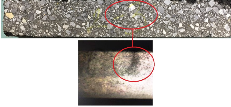
Şekil 4. MA+TMA Numunesinin Çatlak Görüntüsü
