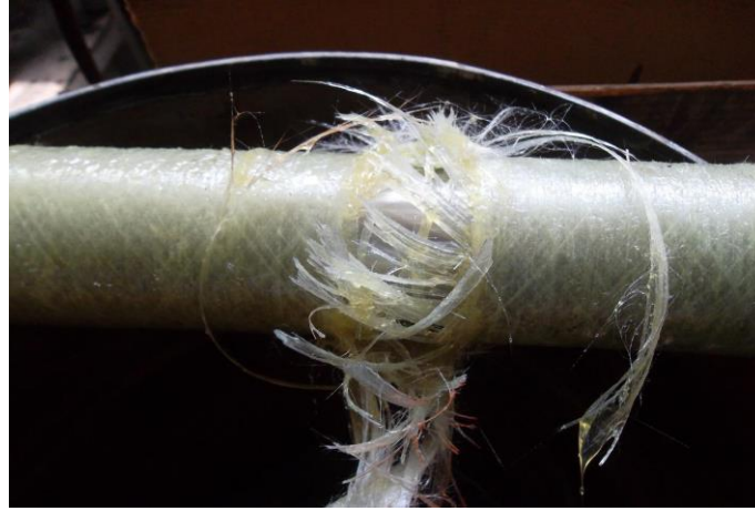
Şekil 11. Patlatma deneyi sonrasında hasara uğramış kompozit boru
