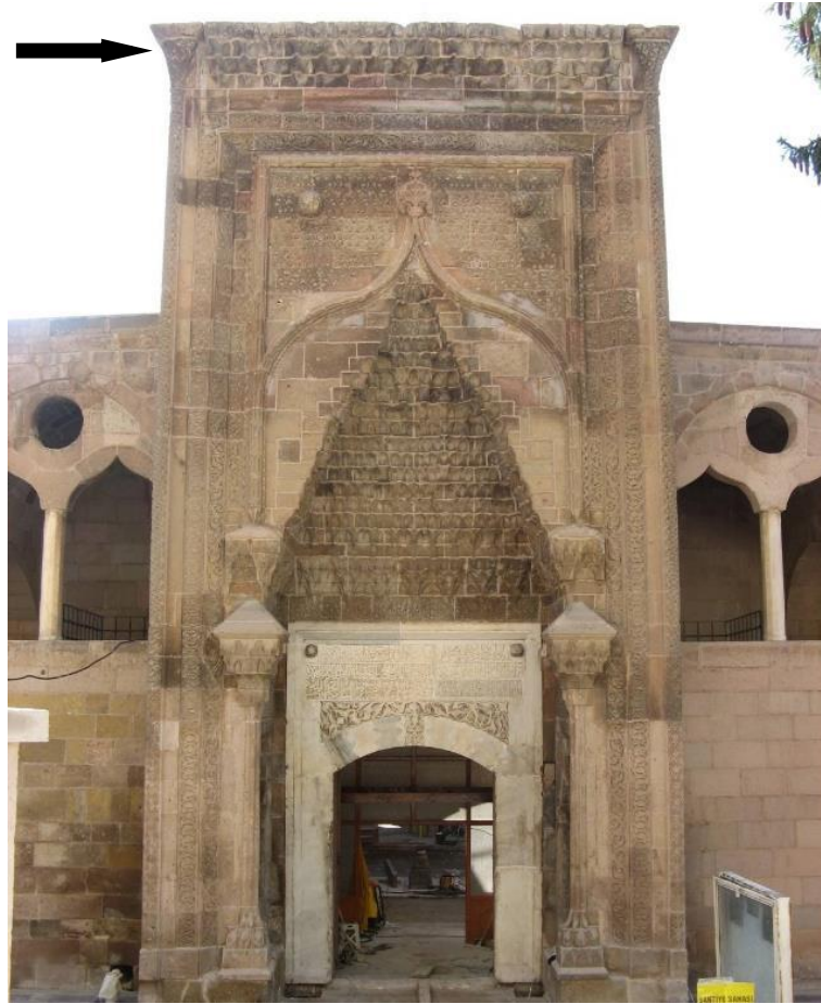
Şekil 16. Taç kapı üst kesiminde yağmur ve kar sularının drenaj sisteminin çalışmaması nedeniyle süslemelerde meydana gelen ileri derecedeki bozunmalar
