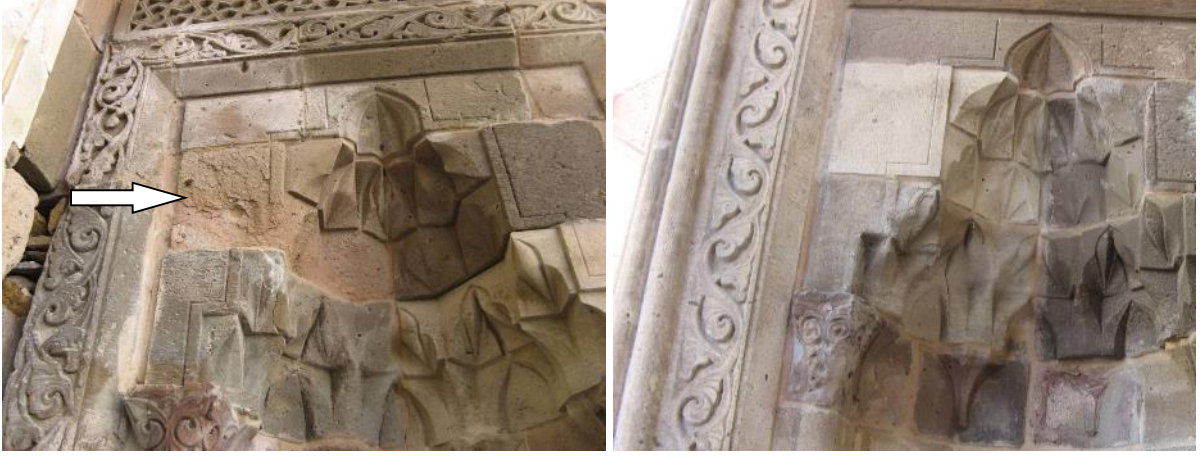
Şekil 17. Giriş portalini sol üst kesimindeki süslemelerdeki önemli kayıplar ve orijinal olmayan taşla yapılan değiştirme işlemi
