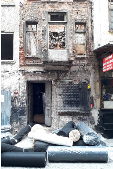
Şekil 17: Çatısı çökmüş, zemini ise depo olan yapı Kaynak: Can Bulubay Arşivi
