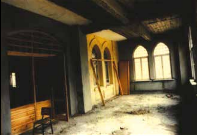
Fotoğraf 8a. Yapıya izinsiz eklenen nitelsiz ek kısımdan görünüm (Balıkesir KVKBK Arşivi). / Views from unqualified illegal additions (Archive of Balıkesir Conservation Board).
