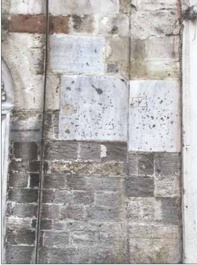
Fotoğraf 6. Hüseyin Ağa Camii Çeşmesi'nin cephesindeki, yanmış olan çeşmeye ait mermer malzeme / Marble material of the burnt fountain on the facade of Hüseyin Ağa Mosque Fountain (Yazıcı Metin 2019).
