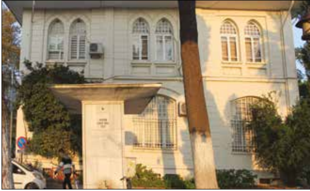
Fotoğraf 9. Güneybatı cephesinde eklenen bölümün özgün yapıdan farklılığının izlenebildiği bir fotoğraf. / A photograph from southwestern facade in which the difference between the illegal additions and the original building can be seen.
