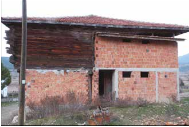
Fotoğraf 58. Modern malzeme ve betonarme tekniği ile yapılan onarımlar, Çarşak Köyü / The repairs made with modern materials and reinforced construction technique, Çarşak Village, 2018.
