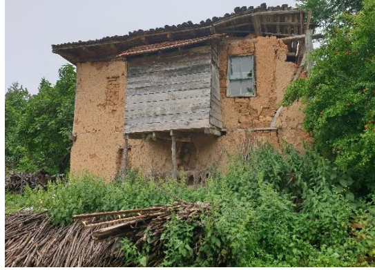
Şekil 23. 214 Ada 5 Parsel dışarıda tuvalet örneği 24 .
