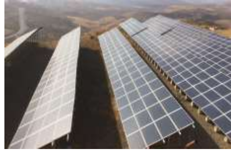
Şekil 2.3. Lebit Enerji güneş santrali görünümü
