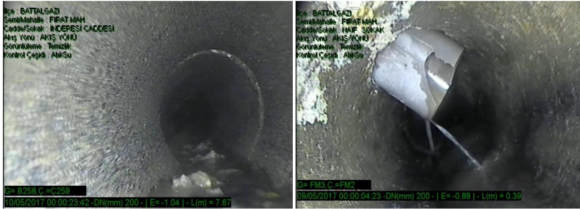
Şekil 2. Yapısal Kusurlar, Boru Hasarı ve Çökme (Orhan, 2018; MASKİ, 2018) (devam)
