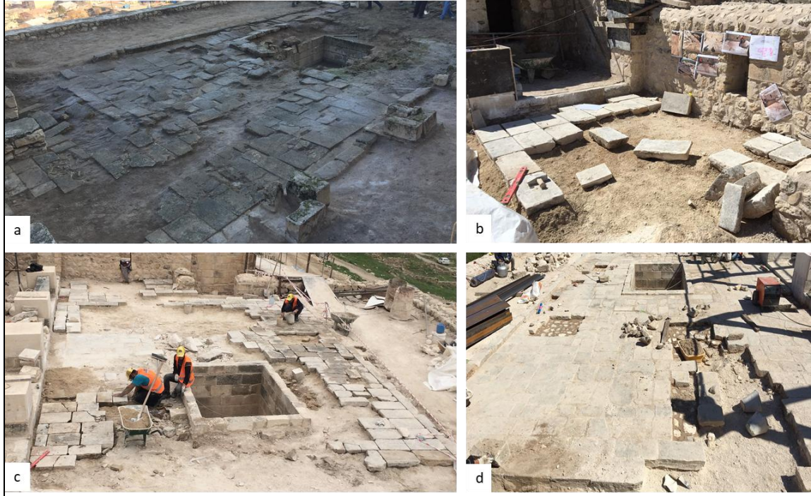
Şek. 19: Yamaç Külliyesi Güney (Cami) Bölümü Avlu Yonu Taş Taban Kaplamalarının Mevcut Durumu (a) ve Özgün Yerlerinde Mevcut Haliyle Sağlamaştırılma Çalışmaları (b, c, d).
