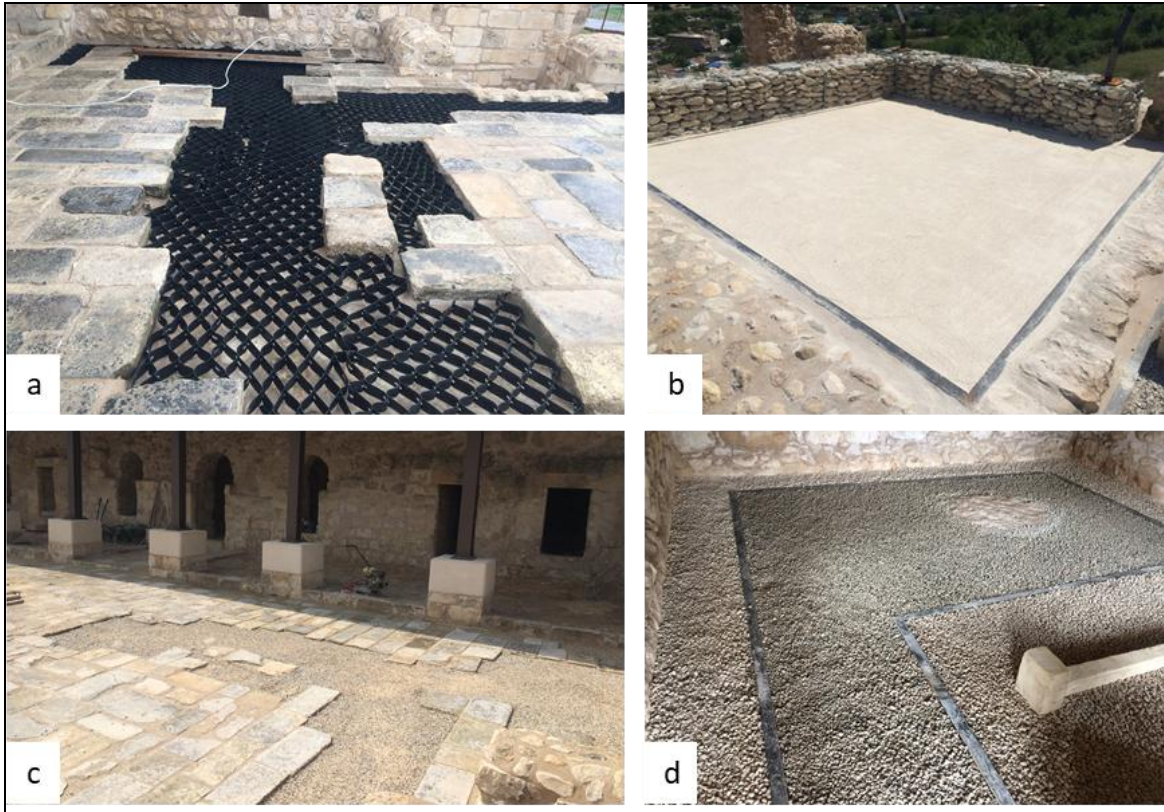
Şek. 31: Yamaç Külliyesi Cami Bölümünün Zemininde Sıkıştırılmış Filler ve Mozaik Kırığı Malzeme ile Yeni Döşeme Yapılması Çalışmaları (a, b, c, d).
