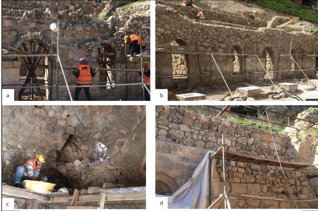
Şek. 16: Yamaç Külliye Kalıntılarının Duvar Örgülerindeki Eksilen Kısımların Tamamlanması Çalışmaları (a, b, c, d).
