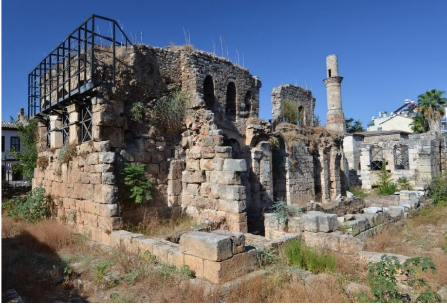
Res. 1: Kesik Minare'nin müdahale öncesi 2007 yılında yerleştirilen çelik konstrüksiyonlar ile kuzey doğudan görünümü (URL 6).
