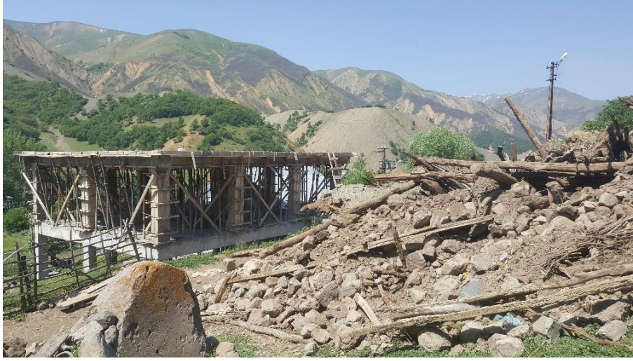
Şekil 10. Betonarme binalarda hasarlar
