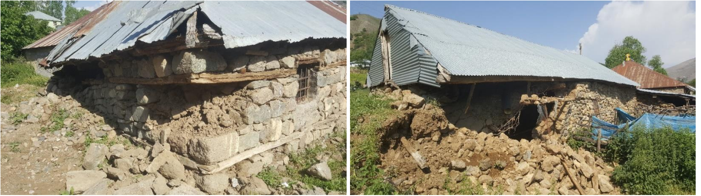
Şekil 6. Kot farklı sebebiyle kısa duvar oluşmasına bağlı hasarlar
