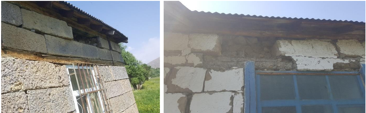
Şekil 7. Çatı ve Duvarlar arasındaki yetersiz bağlantıdan kaynaklı hasarlar
