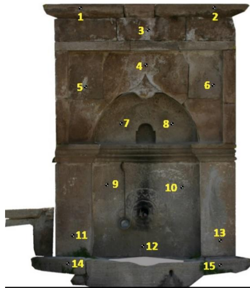
Şekil 3. Lazer işaretleyici ile (Nuri Paşa) çeşmenin işaretlenmesi Figure 3. Mark the fountain (Nuri Paşa) with a laser pointer
