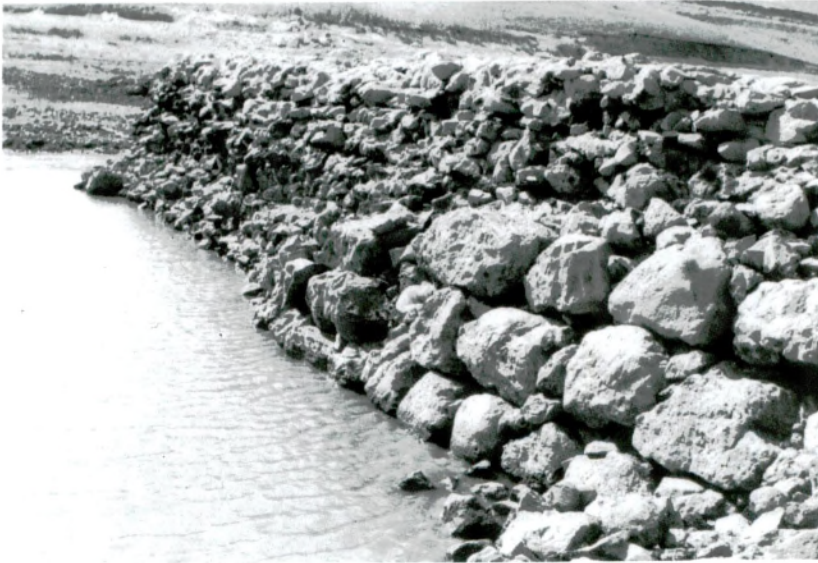
Resim 60 – Birçok kez onarım geçiren ve su altında kalan gölet duvarı.
