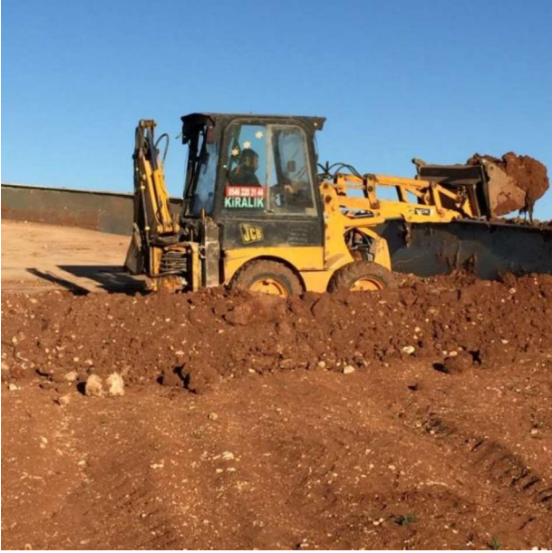
Şekil 16 Çatı döşemesine serilen toprağın göçme sonrası tahliyesi
