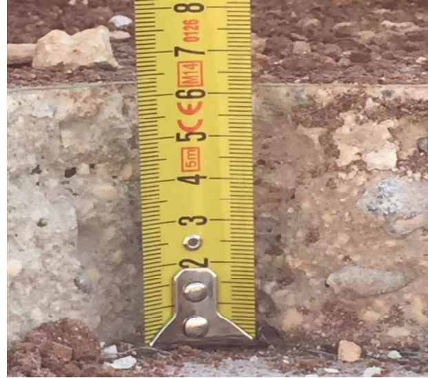
Şekil 10 Döşeme içerisinde 5 cm olması gereken koruma betonu
