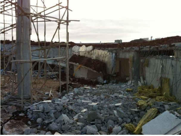
Şekil 5 GAP YENEV binasının göçen konsol kısmından bir görünüm
