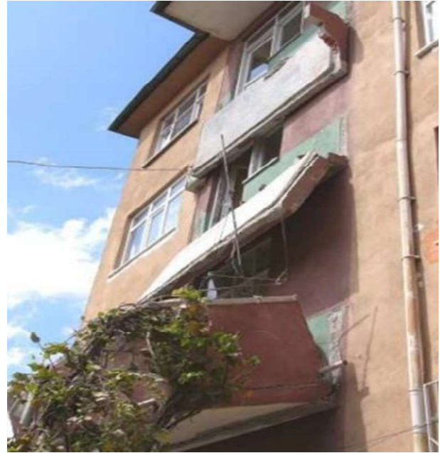
Şekil 4 Betonarme bir binanın göçmüş balkon döşemeleri.
