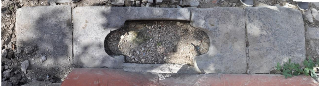
Şekil 14. Aldanzade Hacı Osman Çeşmesi teknesindeki bozulmalar
