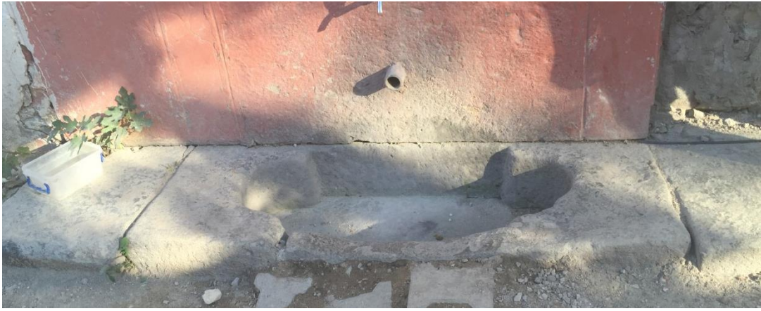
Şekil 10. Aldanzade Hacı Osman Çeşmesi teknesindeki bozulmalar
