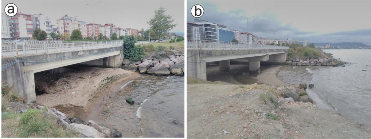
Şekil 7. Karadere (a) ve İncivez (b) deresinde KSY köprüsü altında dalga etkisi ve düşük eğime bağlı malzeme birikmesi sonucu daralan menfezler (Foto: Ahmet Apaydın, 25.09.2020) (In Karadere (a) and İncivez (b) creeks, the culverts narrowing as a result of material accumulation due to wave effect and low slope under the KSY bridge (Photo: Ahmet Apaydın, 25.09.2020))
