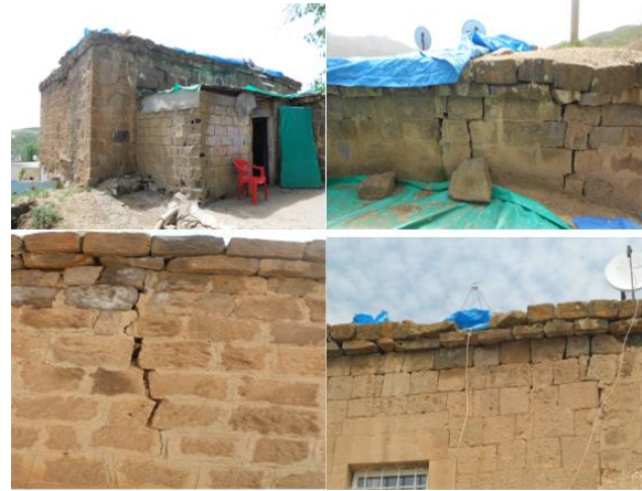
Figure 3. Damages on masonry building-1 (1.Bina hasarları)
