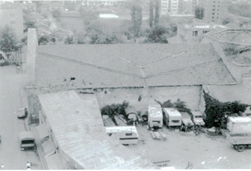
Res. 11 — Ayşekadın Camii minaresinden sol yan görünüş (1990). Muhdes çatı müteahhit Ali Osman Soygel tarafından 1950 senelerinde bu şekle sokulmuştur. Orijinali daha yüksek ve kurşun kaplamadır. 1950 restorasyonu sırasında üçgen alınlığın üzeri koruyucu şap ile kaplanmıştır.
