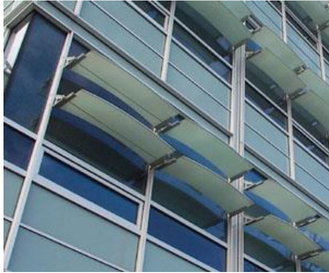
Şekil 5. SURREY vergi binası cephesi ışık rafı uygulaması (Yenidoğan, 2017)
