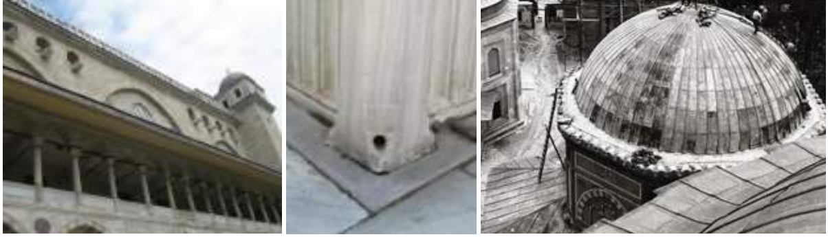
Şekil 5. Süleymaniye Camii'nde çörtlenler (solda) (Yazarlara ait fotoğraf arşivi, 2011), Su Köşkü ayak detayı (ortada) (Aykutlu, 2014: 76) ve Kanuni Sultan Süleyman Türbesi'nde ahşap saçak ve kubbe eteğinde akaçlama detayı (sağda) (Vakıflar Genel Müdürlüğü Arşivi)
