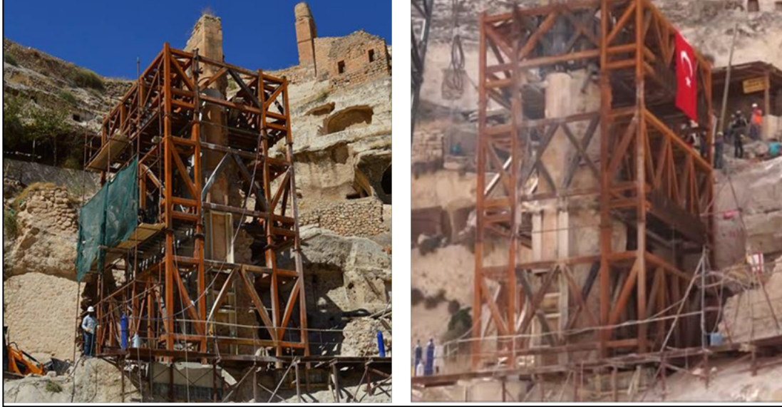
Fig. 7: Hasankeyf Orta Kale Kapısı'nı kaldırma ve taşıma için yapılan çelik taşıyıcı konstrüksiyon
