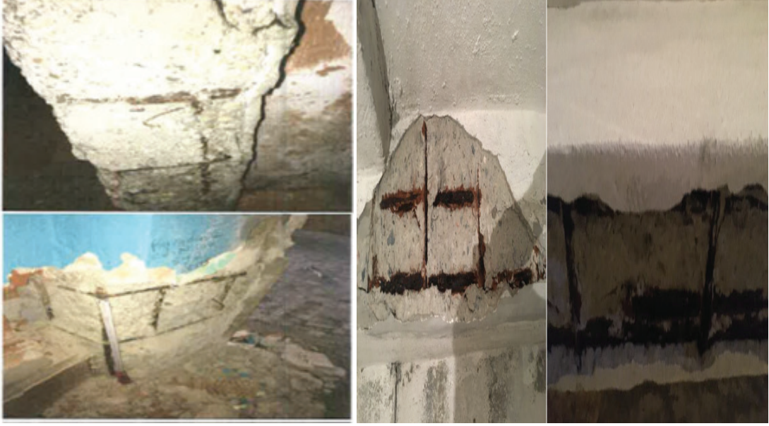
Şekil 4. Kolon ve Kirişlerde Kabuk Atması ve Donatı Korozyon Durumu
