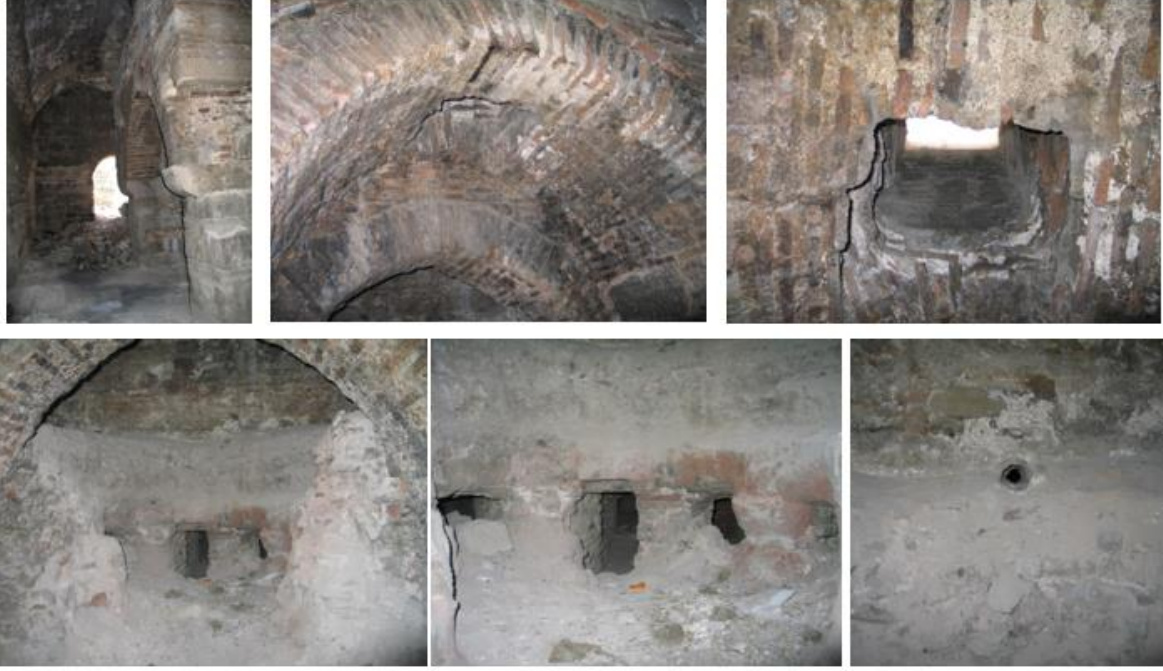
Şekil 11 - Ulukışla Öküz Mehmed Paşa Külliyesi Hamamı; külhan odası, külhan ocak önü kemeri ve bacası, kazanın çıkarıldığı kemer açıklığı ve kazanın oturduğu hazne, parsa delikleri ve sıcak su çıkışı (yazarın arşivi, 2006)
