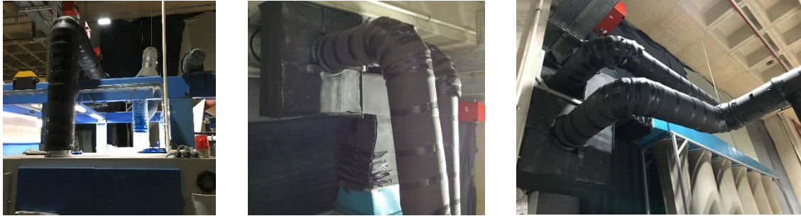
Figure 9. Dust suction ducts covered with IzocamFlex acoustic insulation material ( İzocamFlex akustik yalıtım malzemesi ile kaplanmış toz emiş kanalları )
