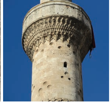
Fot. 18: Hızanoğlu Cami Minarede Dökülmüş Bacini Yuvaları
