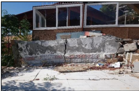
Şekil 3. Bölgedeki kütle hareketinden kaynaklı, bina duvarındaki gözlemlenen deformasyon
