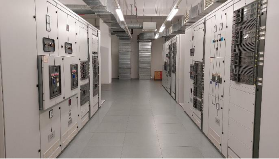
Şekil 14. EnerjiSA Bandırma-I DGKÇS kontrol binası, düşük gerilim odası
