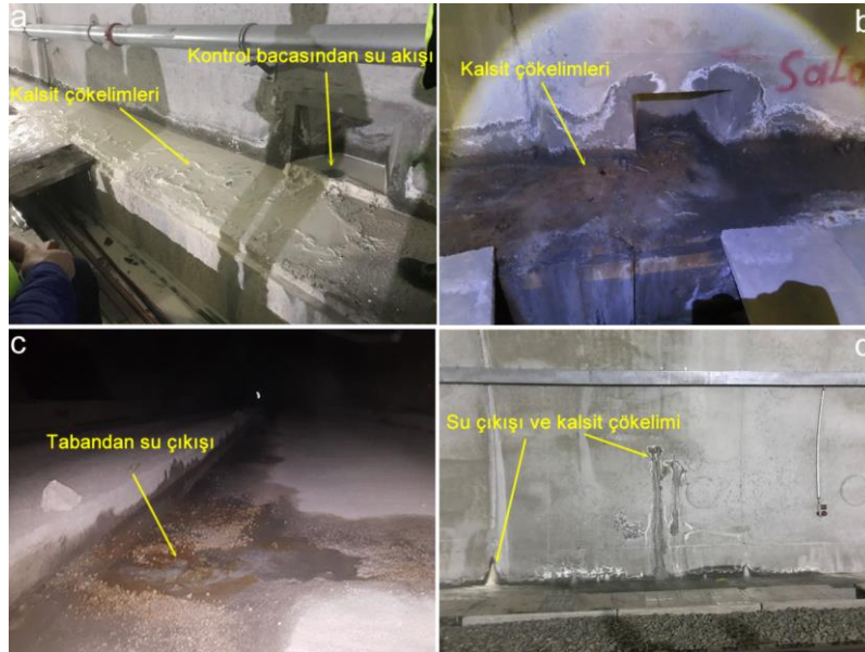
Şekil 18. Tünel içi drenaj sorunları (a: beyaz renkli kalsit çökelimi; b: siyah renkli kalsit çökelimi; c: tünel tabanından su gelişi; d: tünel duvarından su gelişi ve kalsit çökelimi)
