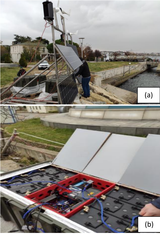
Şekil 7. Tuzla, Denizcilik Fakültesi İTÜ kampüsüne sistemlerin kurulmuş hali (a) Enerji sistemleri ve GNSS antenleri, (b) Sinyal alıcı ünite ve akülerin bulunduğu sistem bileşenleri.
